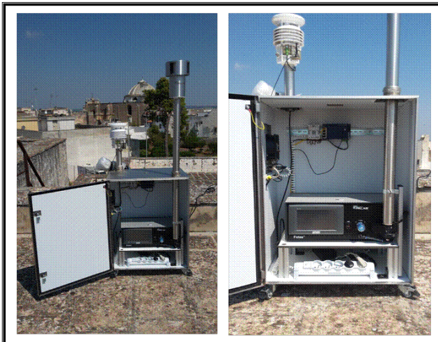
In Fig1: Foto rilevatore di particelle FIDAS 200 installata presso il Comune di Neviano
