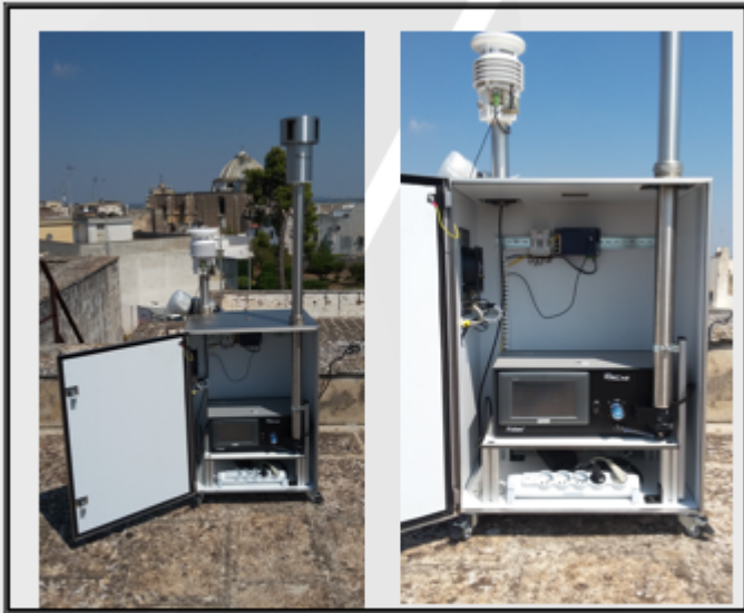
In Fig1: Foto rilevatore di particelle FIDAS 200 installata presso il Comune di Neviano
