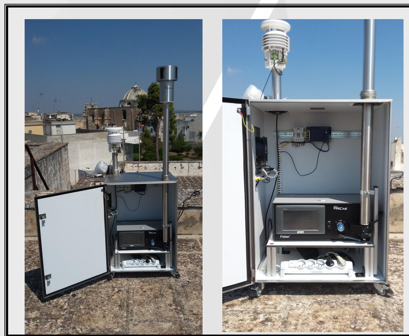
In Fig1: Foto rilevatore di particelle FIDAS 200 installata presso il Comune di Neviano
